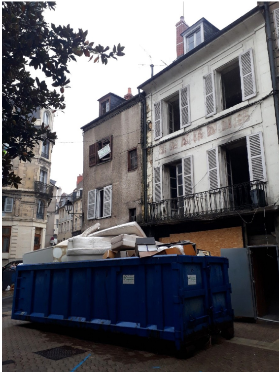
Figure 5. Évacuation des gravats d'un commerce incendié dans un immeuble insalubre
